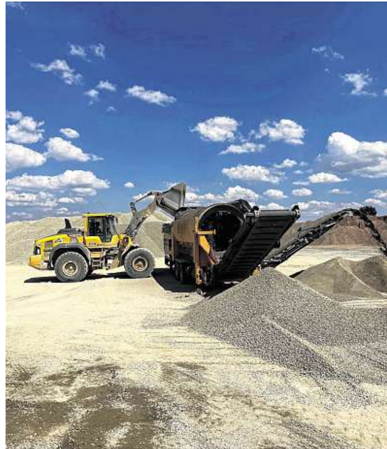
Auf dem Recyclingplatz in Hörblach wird die wiedergewonnene Gesteinskörnung aus der abgerissenen Rothofbrücke ausgesiebt. Brechsand wird dabei entfernt.
